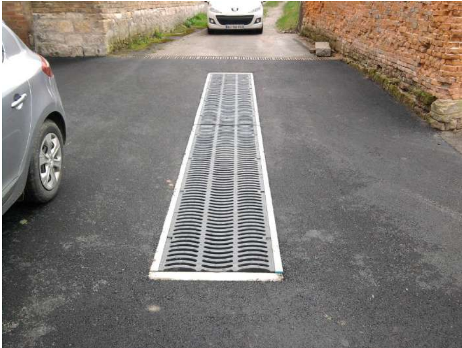
Fig. 12. Caniveau grilles, ARTELIA
