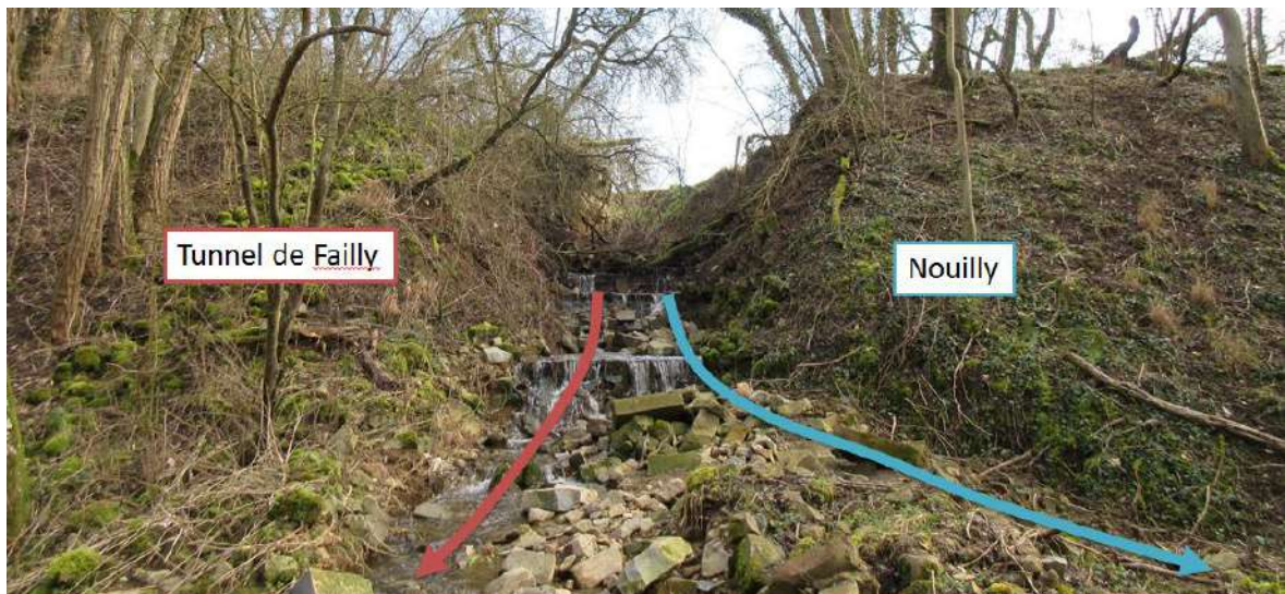
Fig. 47. Écoulement actuel au droit de l'effondrement du remblai (rouge) et écoulement à privilégier dans le cadre de la restauration (bleu)
