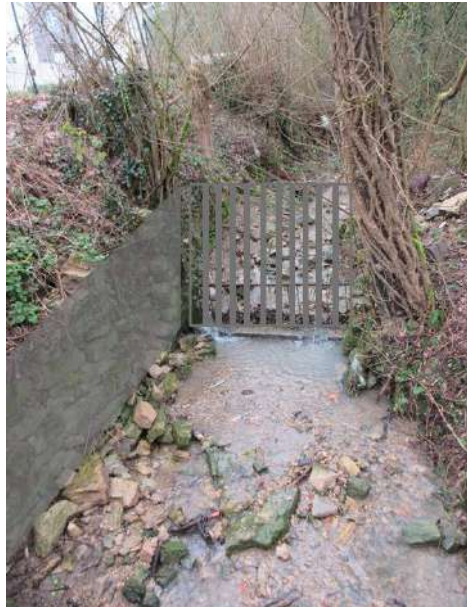
Fig. 52. Mur à reprendre et grille pare-embâcles à redimensionner
